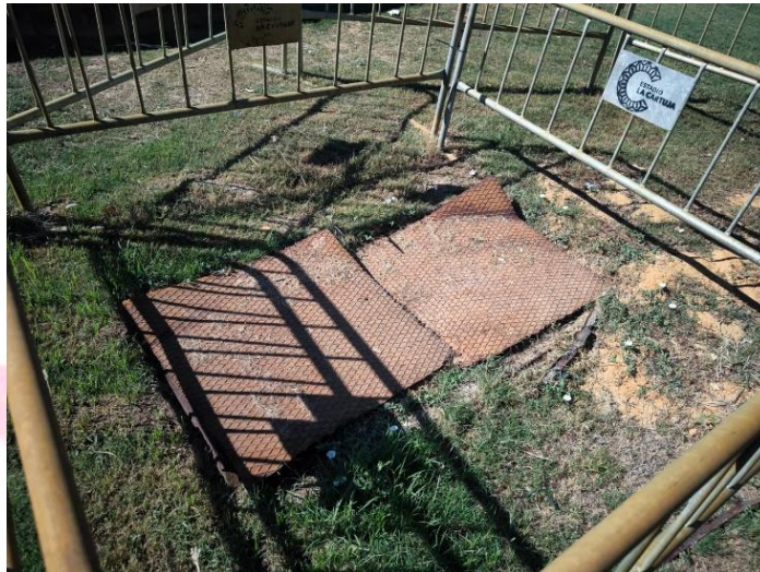
Imagen 7: Arquetas con tapas en mal estado
