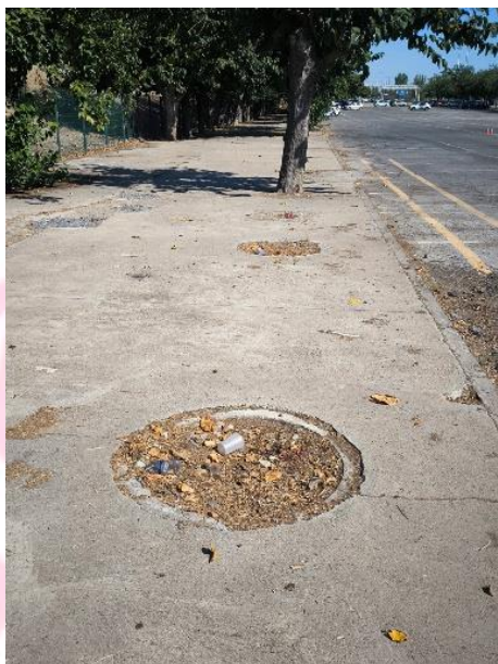
Imagen 12: Estado actual de alcorque circular
