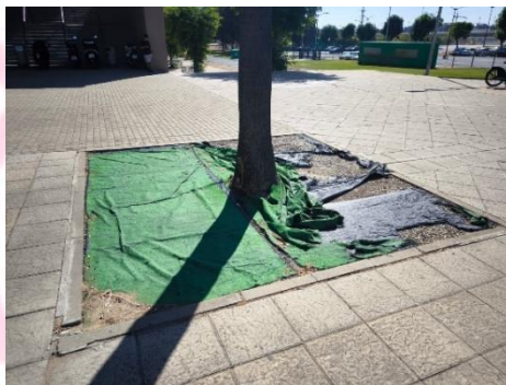
Imagen 10: Estado actual de alcorque
