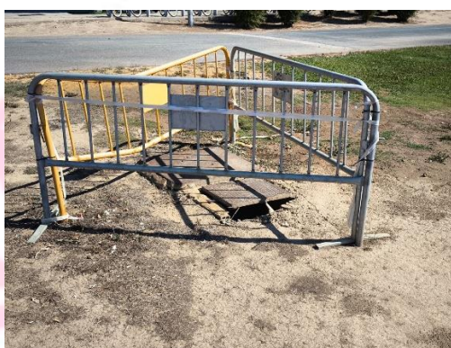
Imagen 5: Arqueta con marco roto
